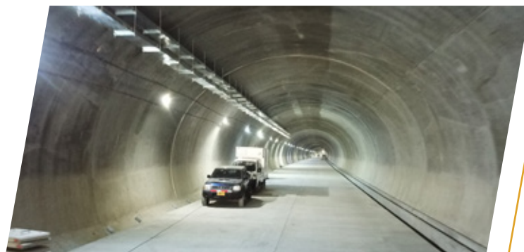
Con la contratación de los equipos electromecánicos, el Túnel Mulatos entra en la última fase de su construcción y adecuación.
