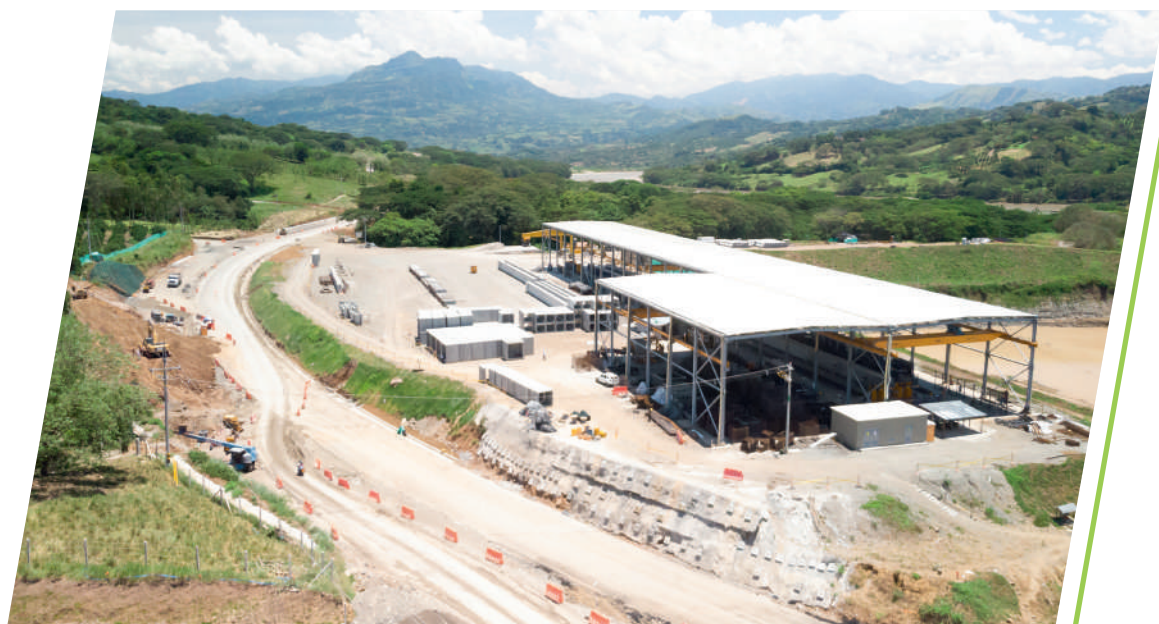
La Concesión adquirió una máquina para construir cunetas y bordillos; con esto logró reducir los tiempos de construcción y estandarización de procesos y acabados.
